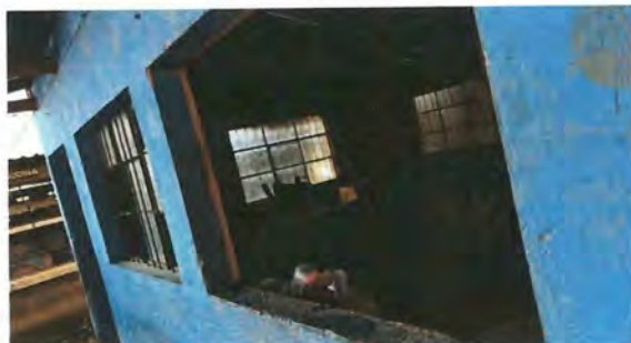
Foto 5: VENTANA EN MAL ESTADO
