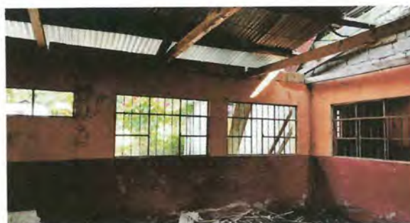
Foto 6: VENTANA EN MAL ESTADO
