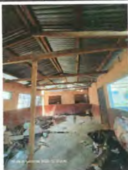
Foto 1: TECHO DE COCINA EN MAL ESTADO
